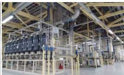
UPW 熱純水熱回收能量再利用
