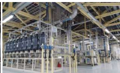
UPW 熱純水熱回收能量再利用
